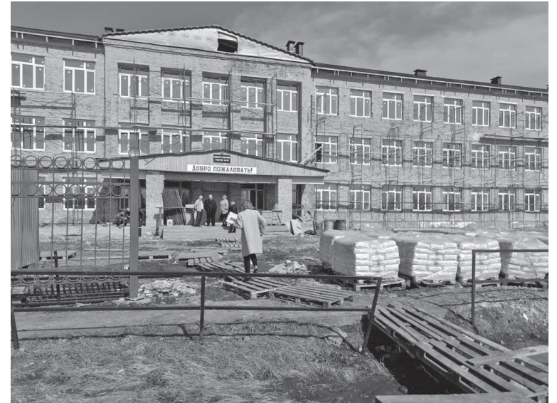
☑ Строители считают, что всё идет по плану. Но очевидно, что до конца апреля объект им не сдать / фото Галины Таскиной "АР"
