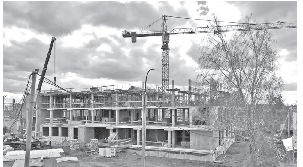
Так выглядит стройка сейчас, но с каждым днем она развивается все больше / Фото: предоставлено АЦРБ
